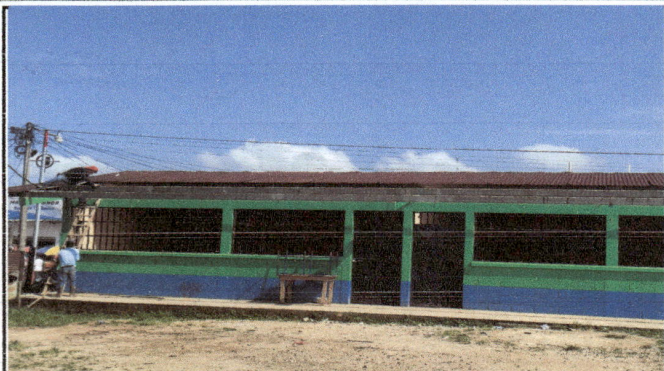
Foto 1: SE OBSERVA EL RETIRO DE LA LAMINA ACANALADA EN MAL ESTADO.
